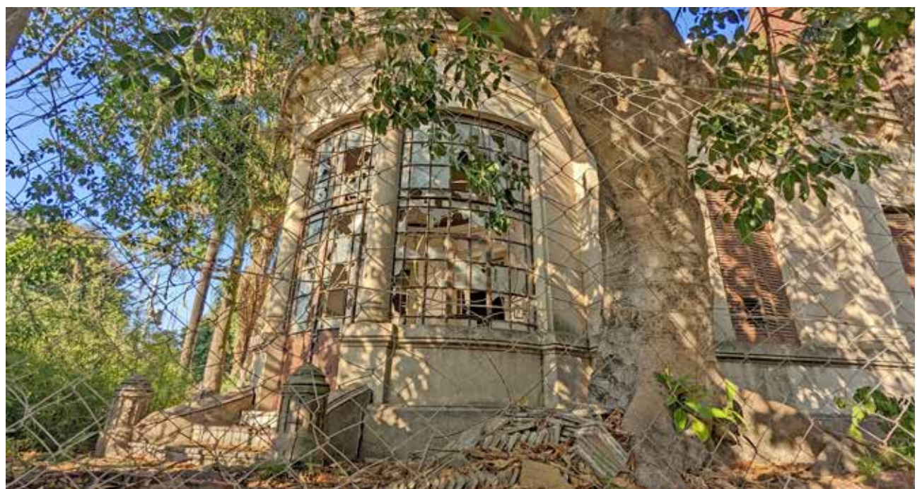
Esquina de la casa de Francisco Beiró, en Marcos Paz y Cantilo, en evidente estado de abandono. /Foto: marzo 2023
